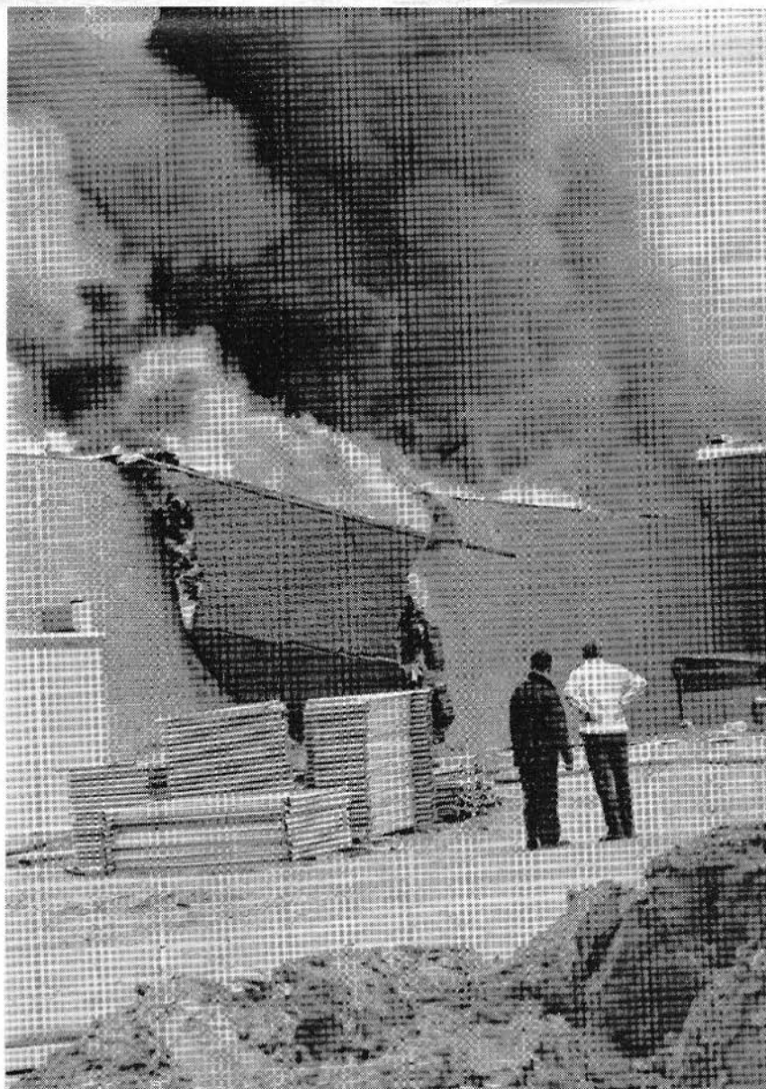
De nieuwgebouwde muur van de montage stort in
